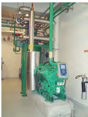
Eksempel på 40 bars ammoniakk varmepumpe for leveranse av varme på ca. 65-68 oC
